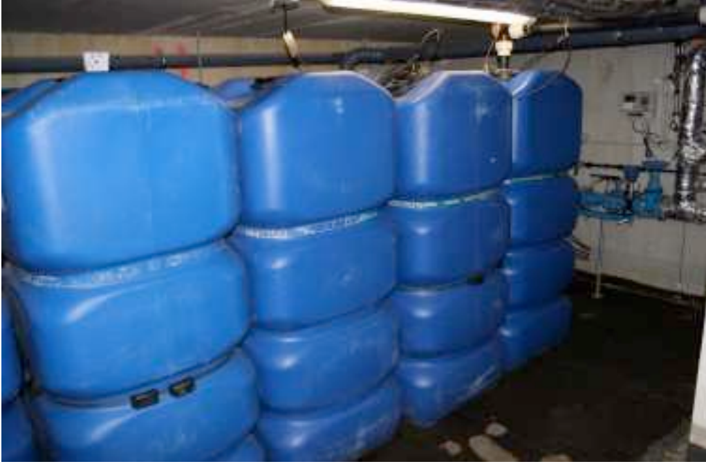
Şekil 3: Yağmur Suyu Depolama Tankları
